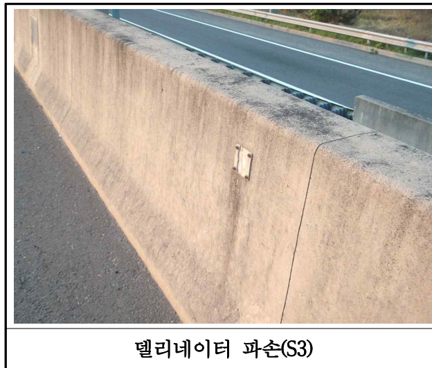
【사진 3.2.22】 기타 시설 손상현황(대구)
