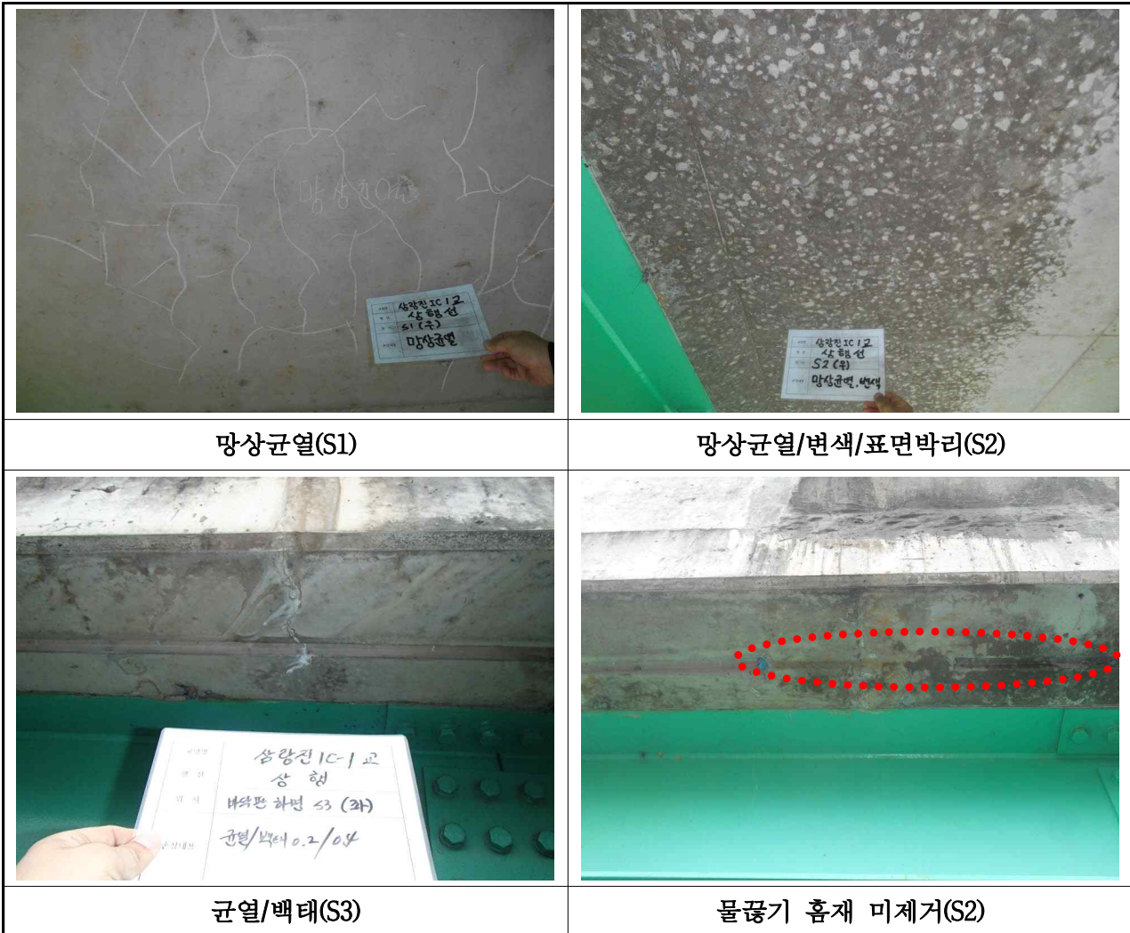
【사진 3.2.2】 바닥판 손상현황(대구)
