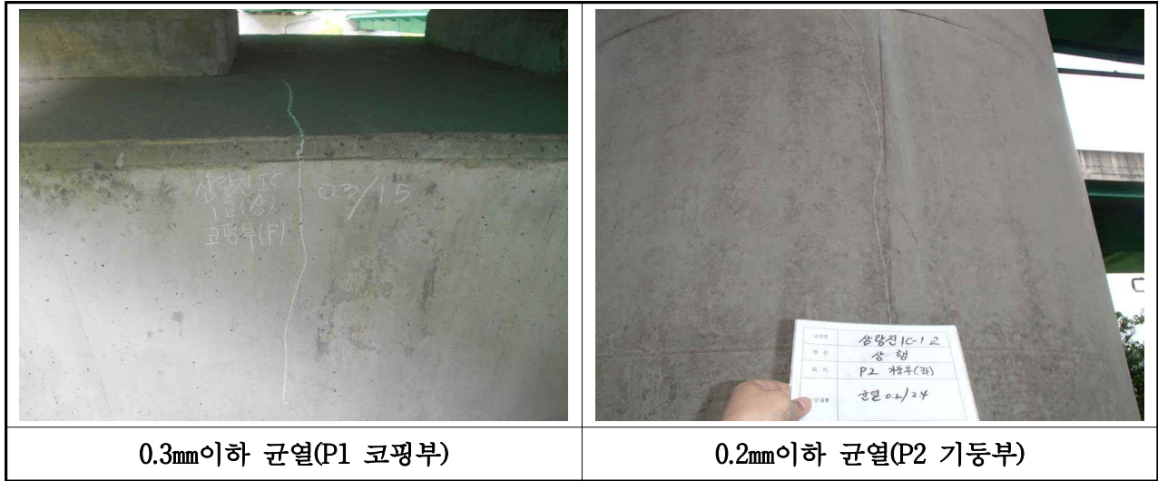
【사진 3.2.10】 교각 손상현황(대구)
