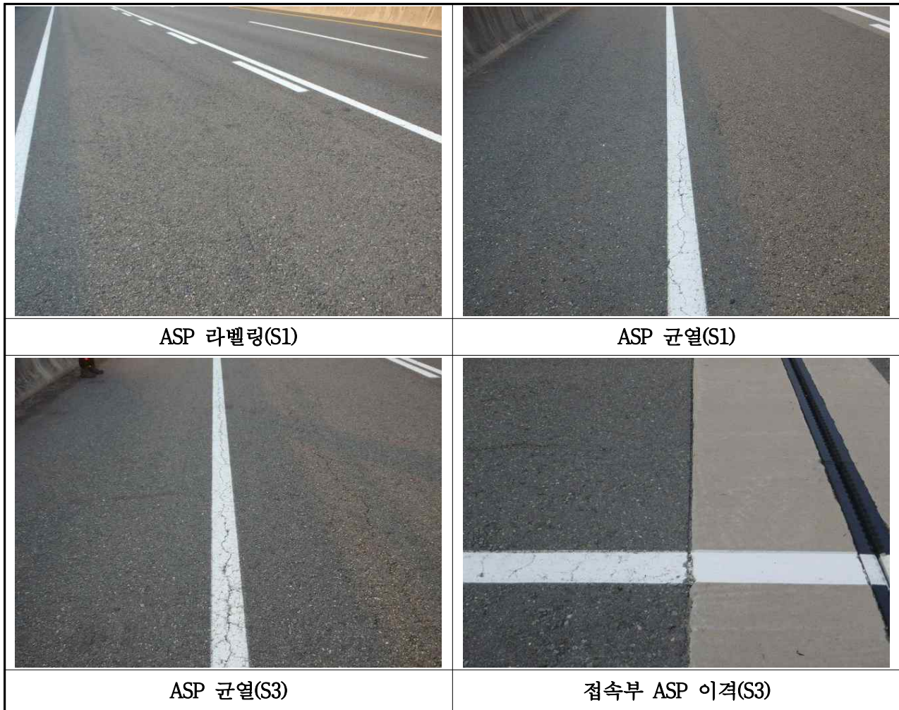
【사진 3.3.17】 교면포장 손상현황(부산)
