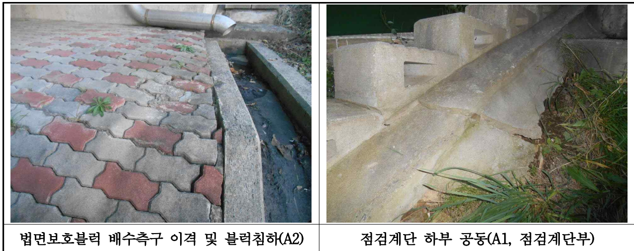
【사진 3.2.8】 교대 손상현황(대구, 계속)
