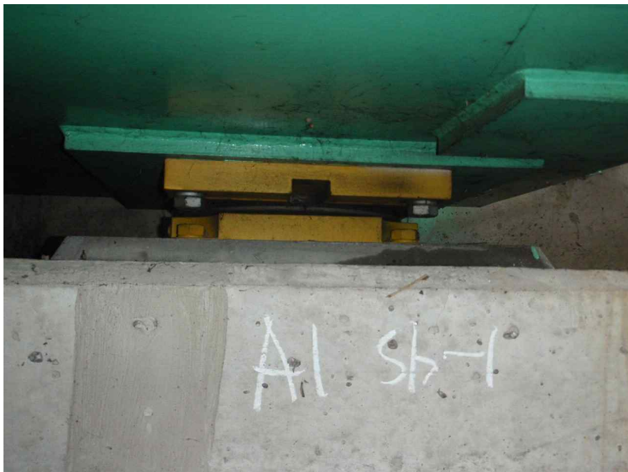
받침장치 전경 (가동단)
