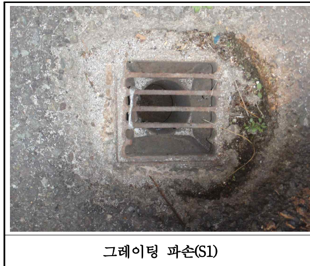
【사진 3.2.19】 배수시설 손상현황
