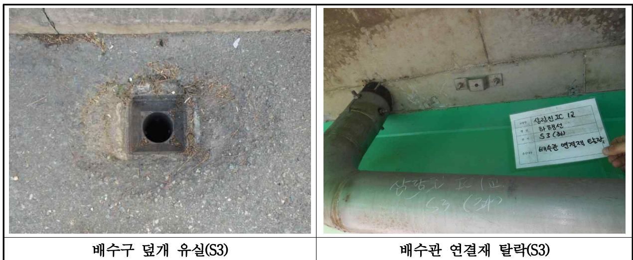
【사진 3.3.19】 배수시설 손상현황
