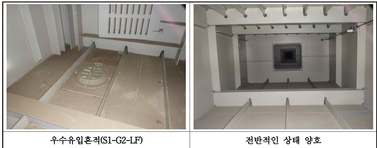
【사진 3.3.4】 강박스 거더 내부 손상현황(부산)
