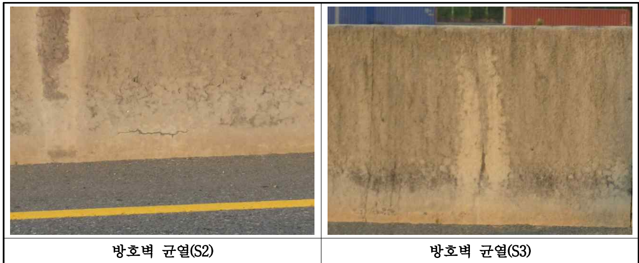
【사진 3.3.21】 방호벽 손상현황(부산)
