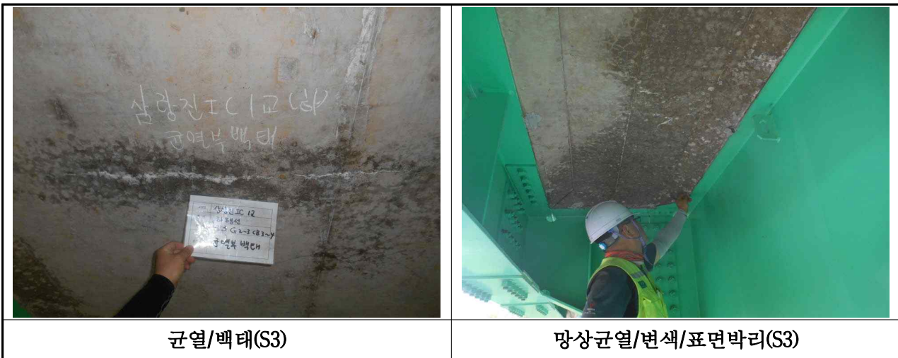
【사진 3.3.2】 바닥판 손상현황(부산)
