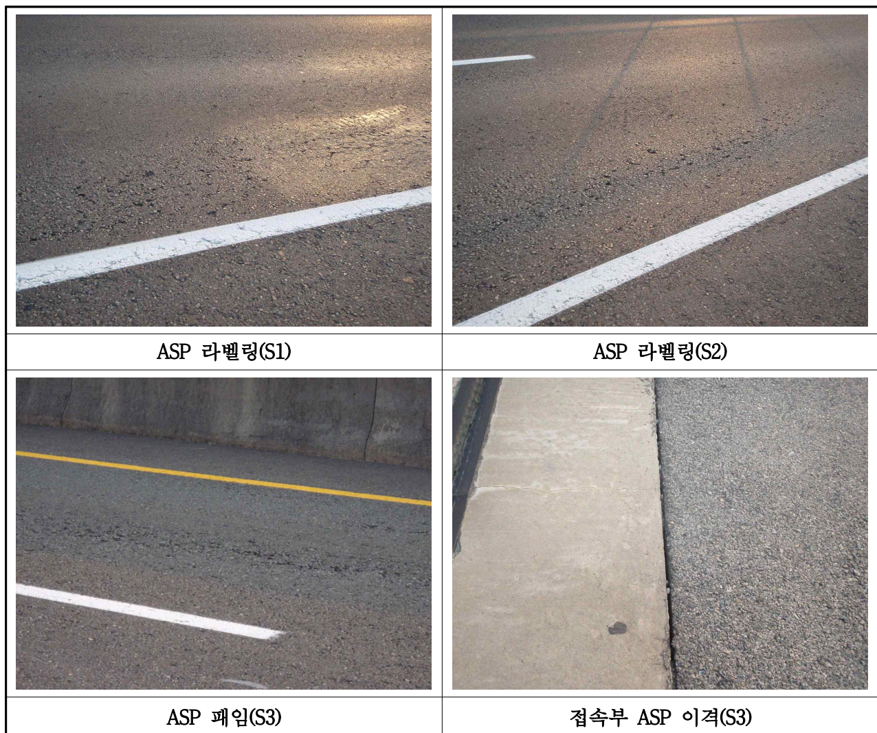
【사진 3.2.17】 교면포장 손상현황(대구)
